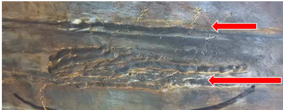
Рис. 2. Растрескивание в кольцевых сварных швах цилиндрического корпуса реактора (вид с наружной стороны), которые были ранее отремонтированы с применением аустенитного варианта сварки (показаны стрелками); поперечные трещины в кольцевом сварном шве; наблюдается распространение трещин на основной металл на малом протяжении (до 20 мм)
