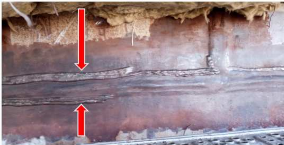
Рис. 1. Места ремонта кольцевого сварного соединения коксовой камеры с наружной стороны (ремонтные аустенитные сварные швы по линиям сплавления показаны стрелками); на рисунке показано наличие повторного ремонта по верхней и нижней линиям сплавления
