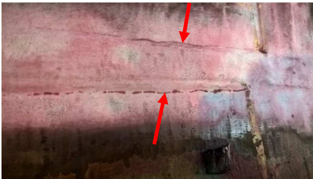
Рис. 4. Несквозные трещины по линии сплавления с нижней и верхней стороны кольцевого сварного шва корпуса коксовой камеры, выявленные в ходе капиллярной дефектоскопии (показаны стрелками) с наружной стороны сосуда
