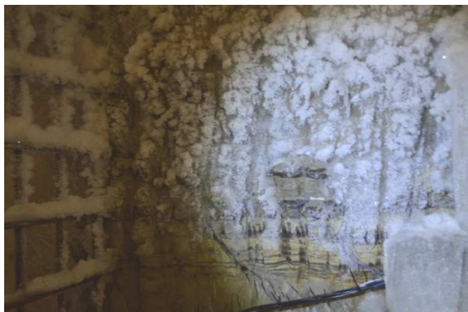
Рис. 5. Выветрелый борт горной выработки ЦВМ с установленным температурным датчиком
