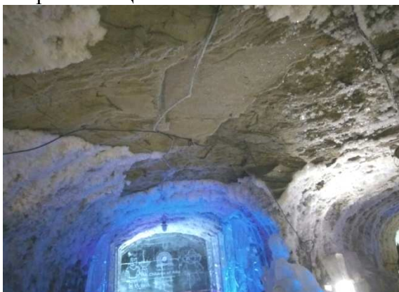
Рис. 1. Вывал пород кровли в районе сопряжения штольни 1 и камеры 4 ЦВМ
