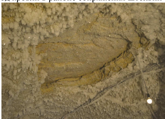
Рис. 2. Отслоение пород кровли
